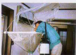
リニアウォーターをくまなく噴霧して、汚れや雑菌を浮かせていきます
