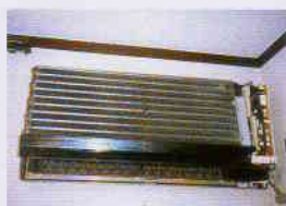
エアコンのカバーをあけた状態。11年分の汚れで全体が黒ずんでいました
